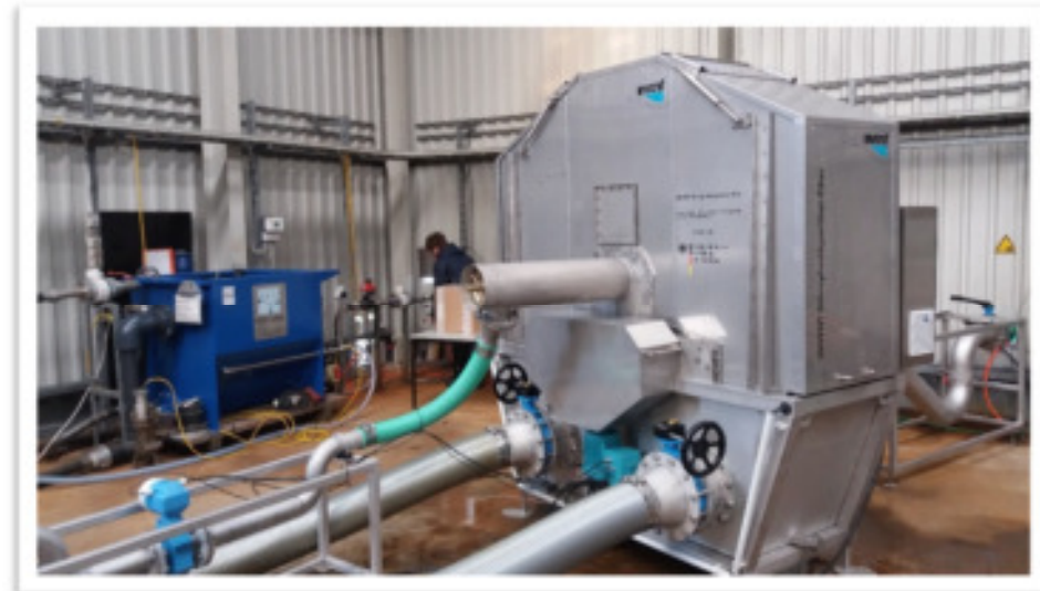
Anlage auf Klärwerk Ruhleben
