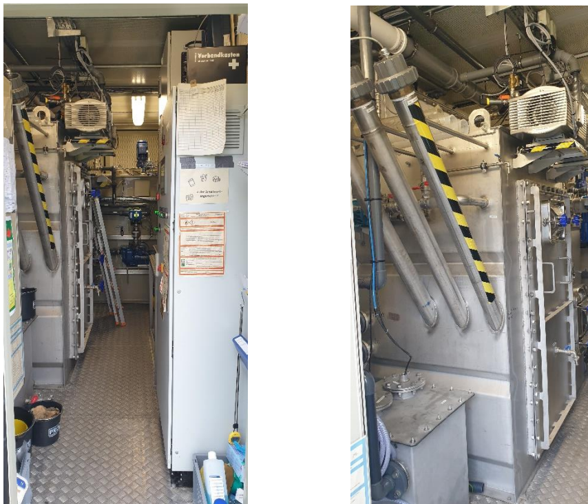
Abb. 11: Innenraum des Containers, in dem sich die Pilotanlage befindet (links) und Blick auf den Filtrationstank (rechts)
