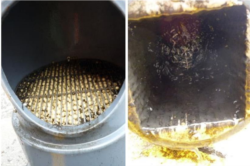
Abbildung 4.11: BUDAVINCI Typ-N, Filterpatrone gereinigt (links), Zulauf unten verschmutzt (rechts)
