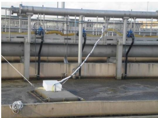
Abbildung 11: schwimmende Haube auf dem Becken 3.2 zum Auffangen des Reingases
