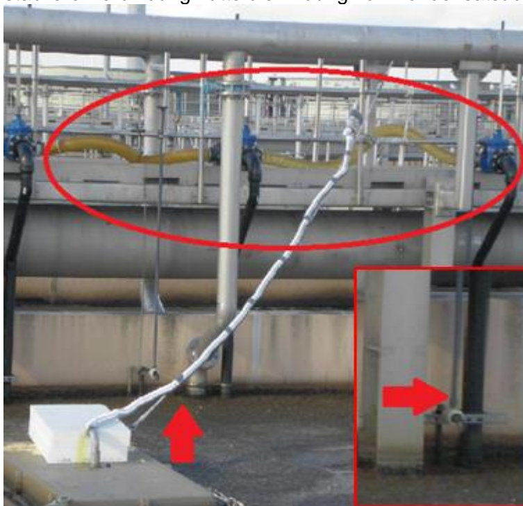
Abbildung 29: Belüfter mit ausgedehnter Schlauchleitung
