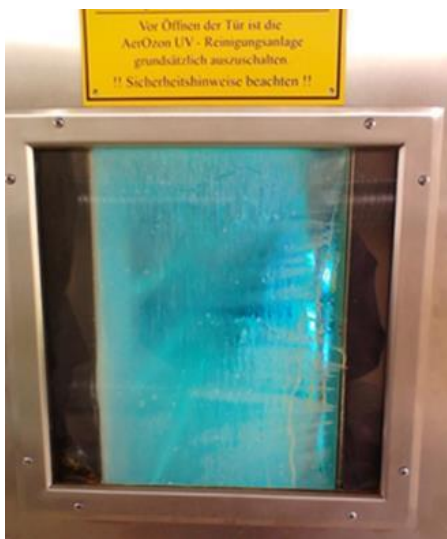
Abbildung 38: Sichtfenster des UV-Reaktors mit gelbem Belag; rechtsseitig: Lampen funktionieren; linksseitig: Lampen sind defekt
