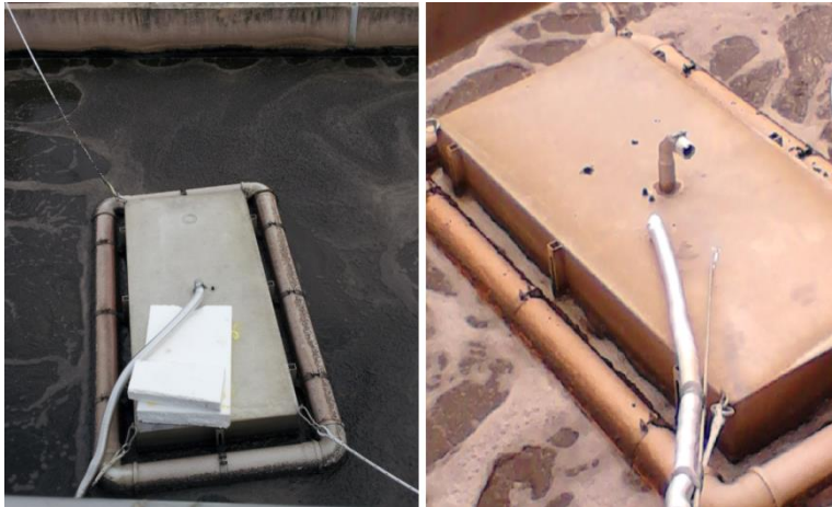
Abbildung 30: Defekte an den schwimmenden Hauben
