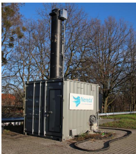
Abbildung 38: Foto der Pilotanlage auf dem Klärwerk Stahnsdorf
