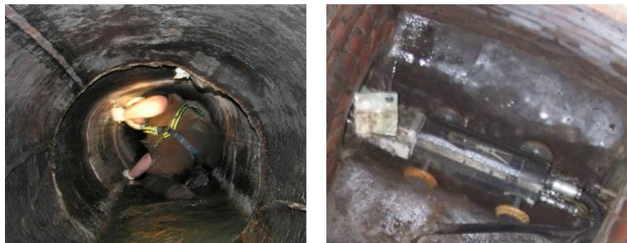
Abbildung 3: Entnahme von Proben aus Haltungsbereich: links: händische Entnahme aus begehbarem Profil (aus [13]), rechts: Entnahme mittels Fräsroboter (aus [11])
