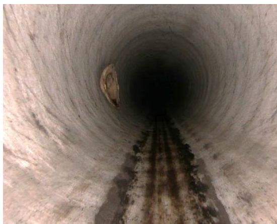
Abbildung 12: Abflusshindernisse in einem Liner (Foto: BWB)
